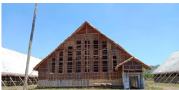
Gambar 2. Dilatasi Pada Rumah Tembakau
